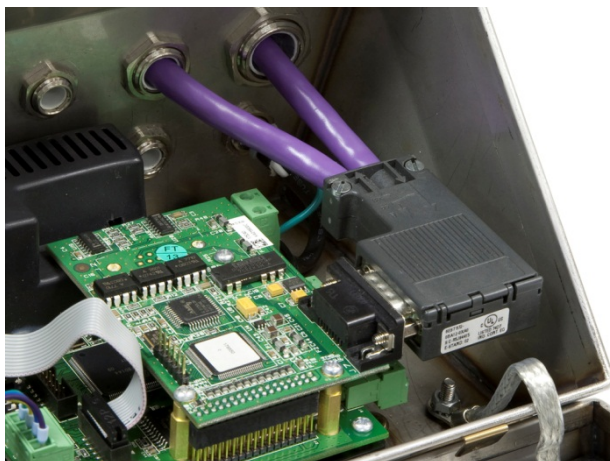
Figure 2-69 : Acheminement des câbles PROFIBUS pour boîtier version environnement rude
