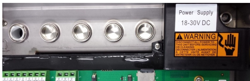
Abbildung 2-5: Gleichstromanschluss mit Abdeckung
