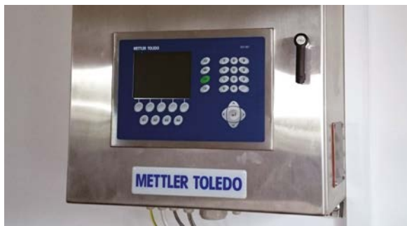
Ein IND9R86 Controller steuert den dynamischen Wägevorgang und speichert das Gewicht jedes Waggons.
