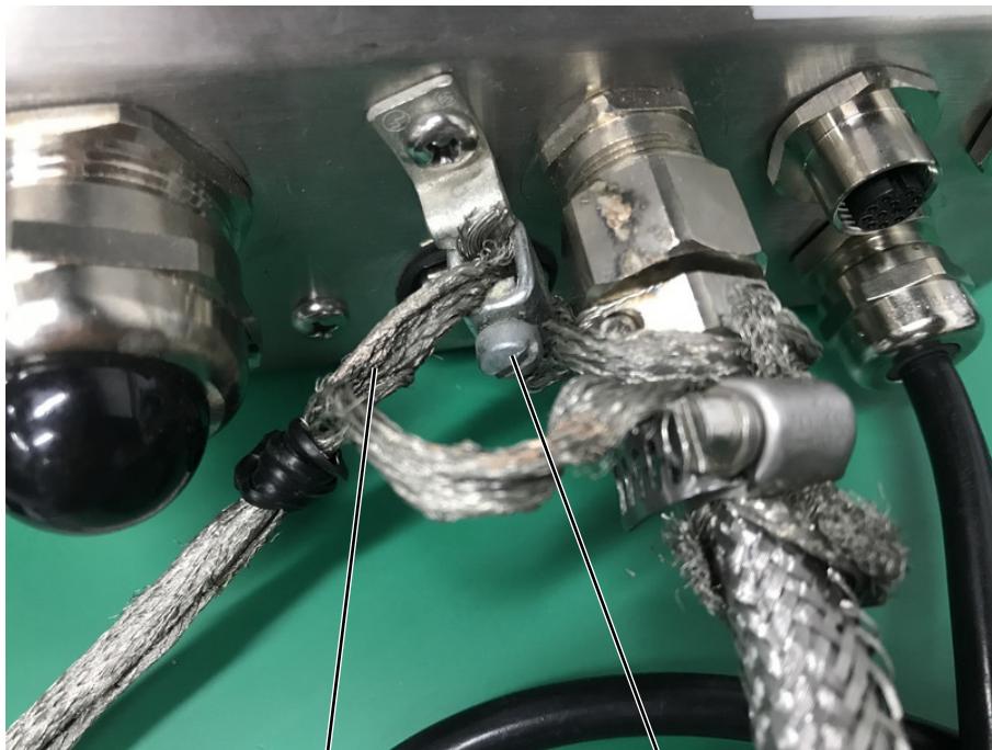
Cable de drenaje exterior
