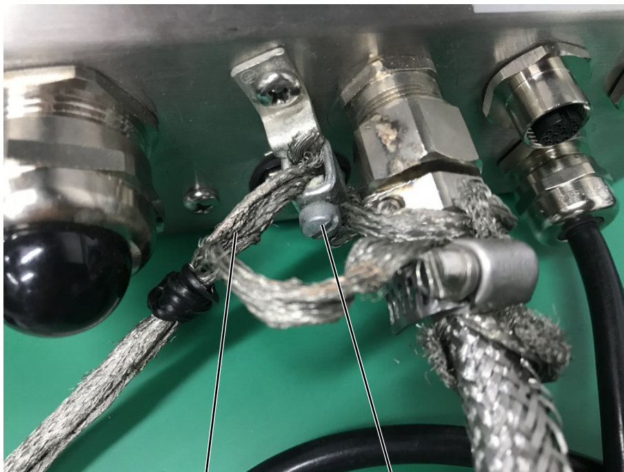
Fio de Drenagem Externo Dispositivo de Aterramento
