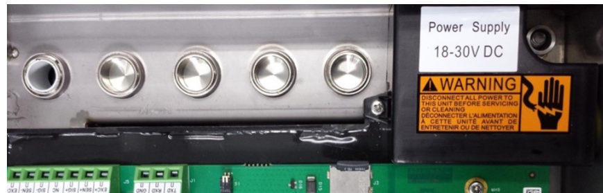
Abbildung 2-5: Gleichstromanschluss mit Abdeckung
