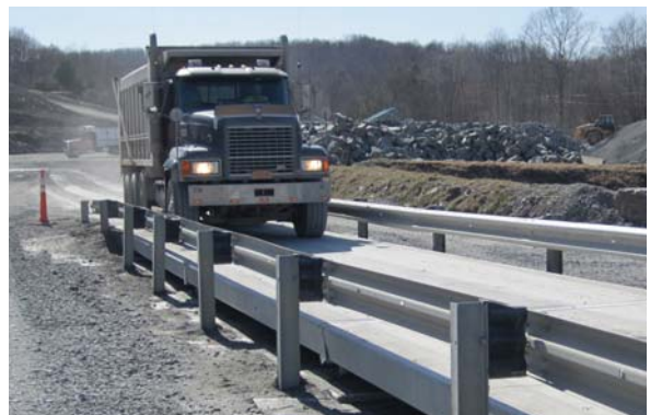
比如, 采石场, 你会发现一台无基坑(侧面敞开式)汽车衡很容易清理周边撒落的杂物
