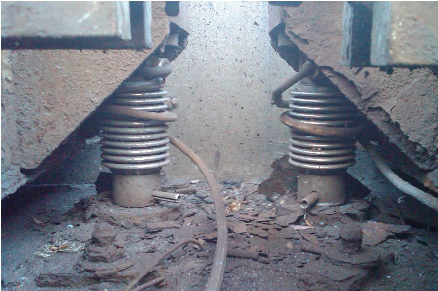
หากโหลดเซลล์แบบเสารับแรงอัดมีคุณสมบัติด้านการหมุนที่ไม่เพียงพอ จะทำให้สายเคเบิลพันรอบโหลดเซลล์และเสียหายในที่สุด
