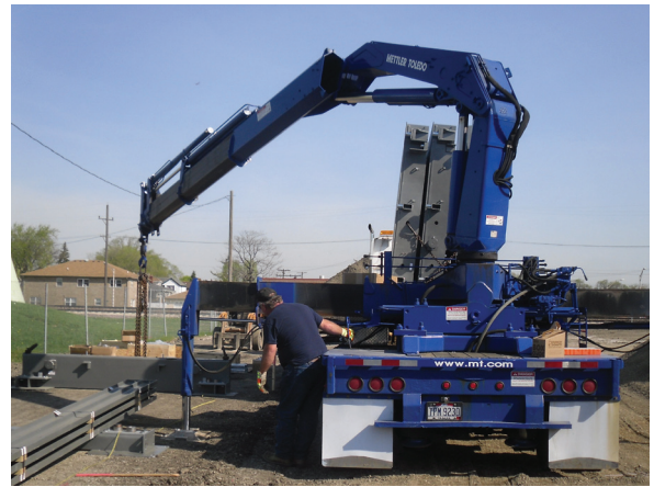
การประกอบโครงเครื่องชั่งรถบรรทุกแบบเคลื่อนย้ายได้บนไซต์งานที่เป็นพื้นดินอัดแน่นซึ่งจัดเตรียมไว้แล้ว
