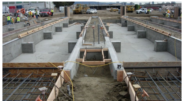
基礎の準備はスケールのコンポーネントがサイトに届く前に行ないます
