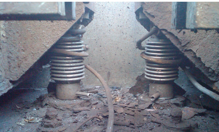
Si una celda de carga de estilo de compresión tiene funciones antirotación inadecuadas, con el tiempo el cable puede enrollarse alrededor de la celda de carga y romperse.
