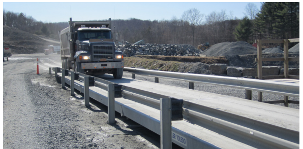
Estos barandales autónomos se instalan en el piso a lo largo de la báscula para ofrecer solidez adicional y evitar que los camiones se desvíen del costado de la báscula
