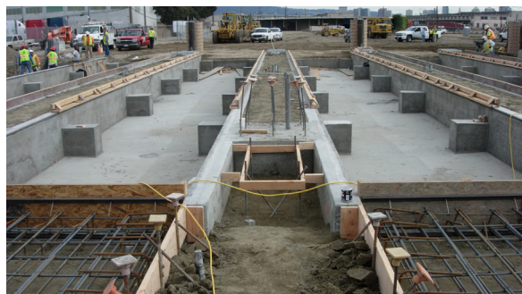
La preparación de la cimentación puede tener lugar antes de que los componentes de la báscula lleguen al sitio
