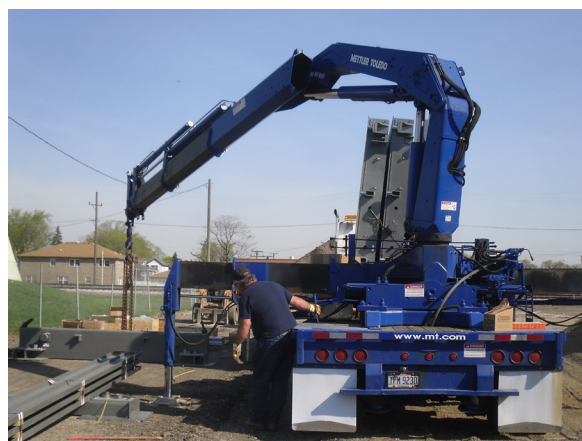
Armado de una báscula para camiones con bastidor portátil en suelo preparado compactado
