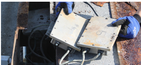
Las cajas de conexiones contienen placas de circuitos y varias conexiones de cables manuales. Son la principal causa del tiempo de inactividad de las básculas para camiones porque son difíciles de mantener protegidas contra la humedad
