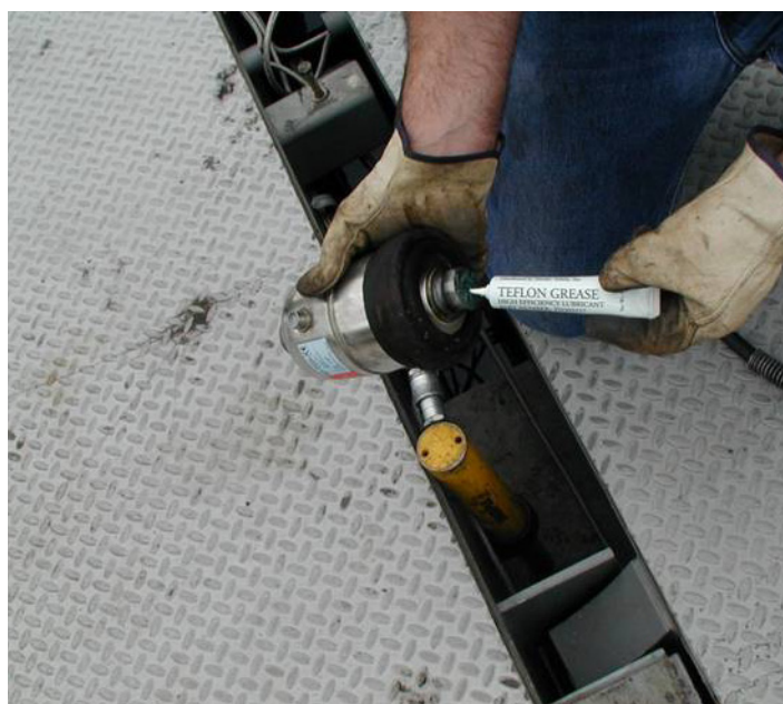
Algunas áreas, como las superficies de acoplamiento de las celdas de carga, requieren lubricación periódica
