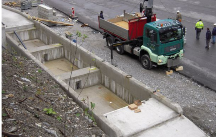
La cimentación de la báscula debe incluir rutas de aproximación adecuadas que cumplan las normas locales
