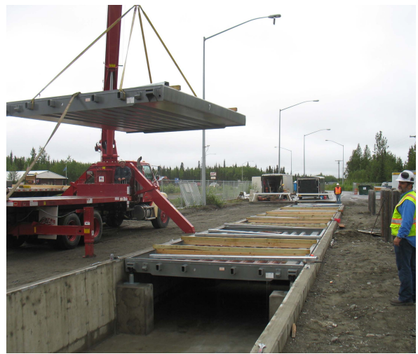
Eine Grubenwaage wird bündig mit dem Boden in einem ausgehobenen Fundament platziert
