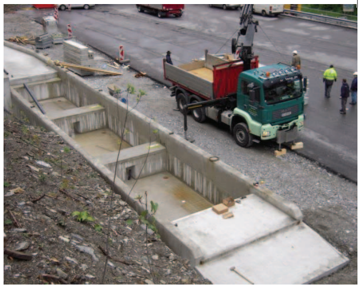
Das Waagenfundament muss über Rampen verfügen, die den vor Ort geltenden Bestimmungen entsprechen
