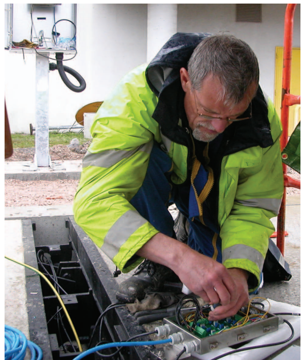
Ein Techniker prüft die Kabelverbindungen einer Wägezelle in einem Anschlusskasten
