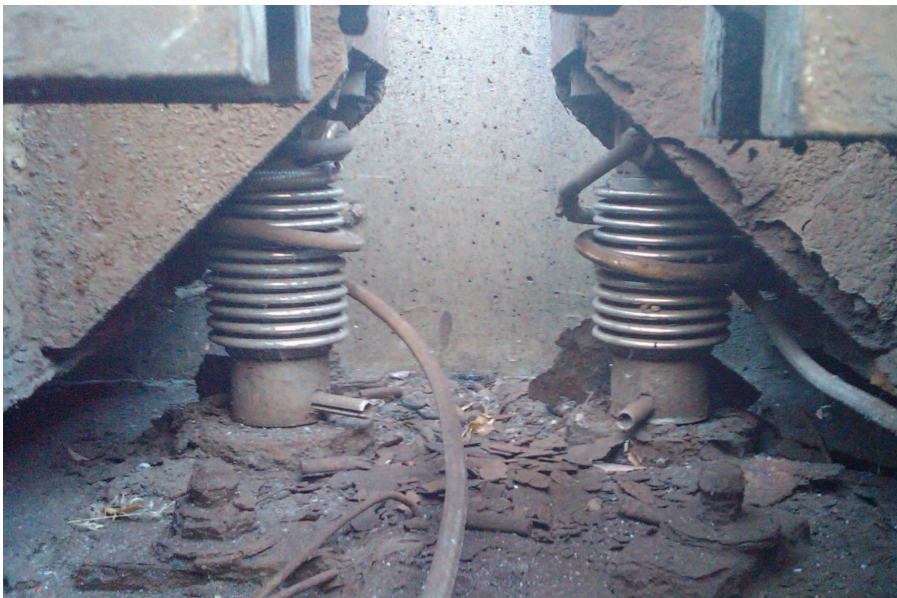
Eine kompressionsbasierte Wägezelle besitzt keinen ausreichenden Rotationsschutz, sodass sich die Kabel um die Wägezellen wickeln und brechen können
