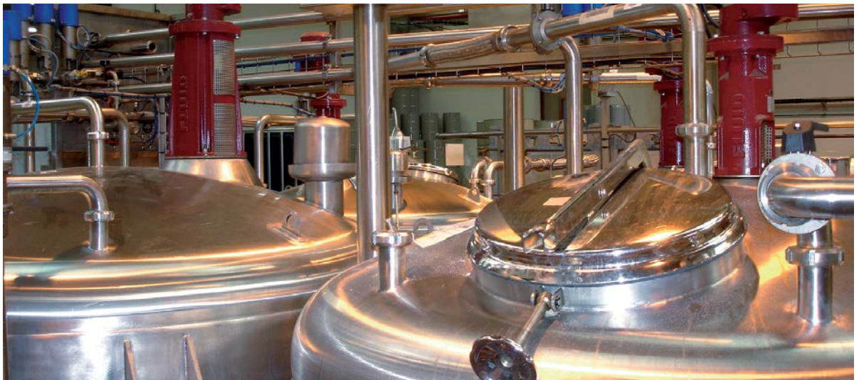
Depósitos con varias tuberías conectadas
