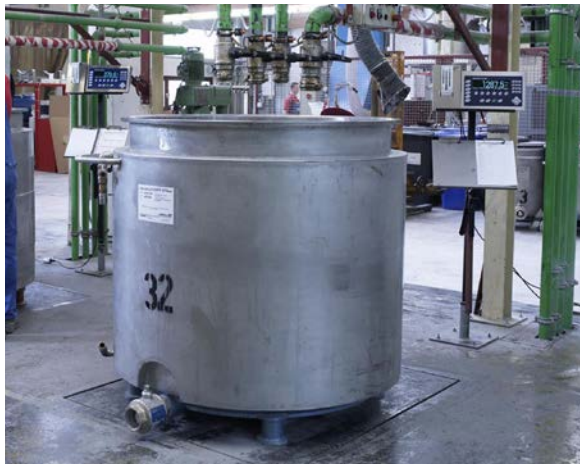
Depósito con tuberías no conectadas
